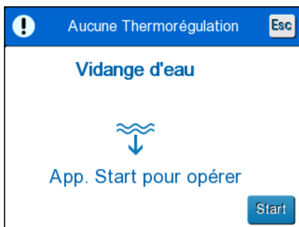
Figure 34 : Panneau de démarrage de la vidange
